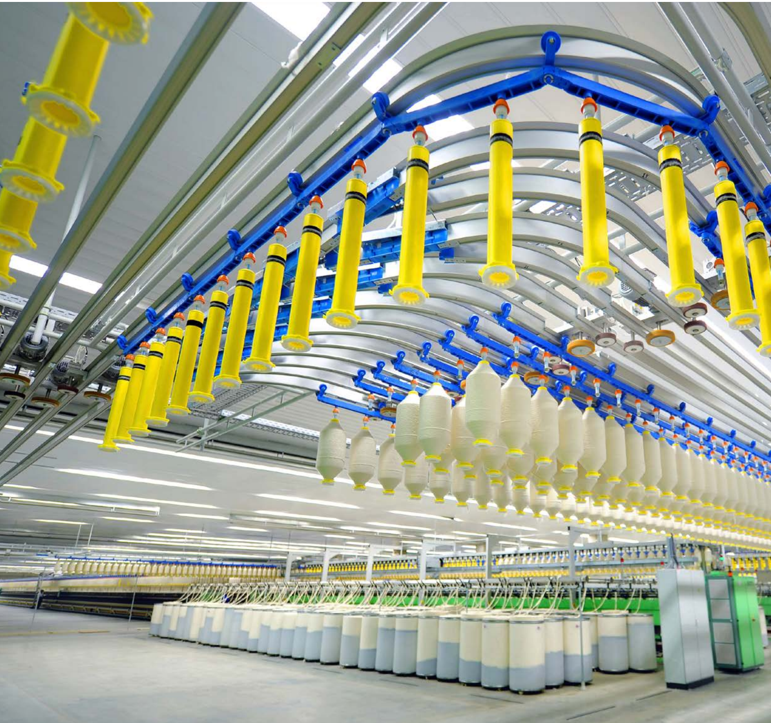
图1 粗纱纱管运输系统SERVOtrail – 保证纺纱厂高效高质不可或缺的部分。
